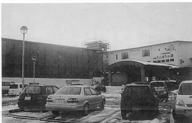
先号掲載の北の入口野積の岬温泉。 こちらは南の入口深層海洋水浴場の増築工事。 今年4月開場で已に増築と言う盛況振り。
