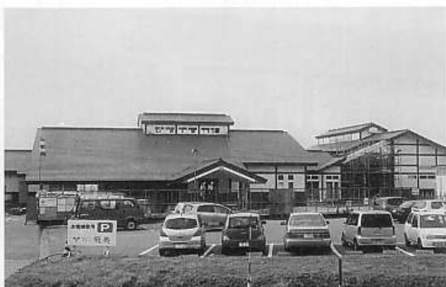
野積岬温泉日帰り浴場の工事が四月の開業を目指して急ピッチに進められている。 外観はほとんど完成。
