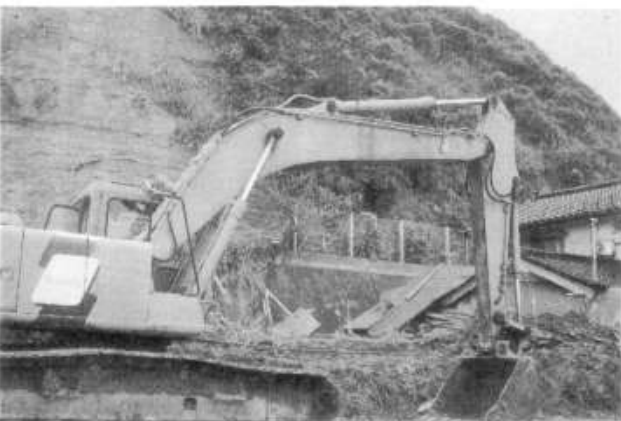
402号線沿いの山田地内の崖が崩れて海岸まで土砂が押し出され、ここも通行不能となった。
