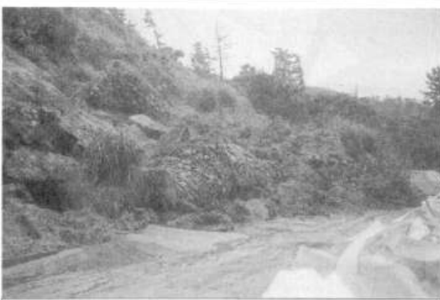
海岸道路国道402号線が水族館前で崩落、通行不能となり、復旧には数日を要する結果となった。
