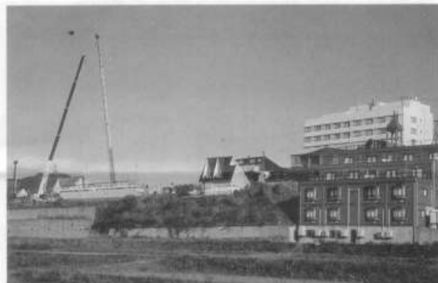
野積の岬に湧出した温泉を利用するの浴場建設の工事が始まった。手前の建物アネックス飛鳥と奥のホテル飛鳥と連動することになる。
